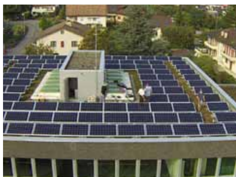
Bestehende Anlage auf dem Gemeindehaus Küttigen.
