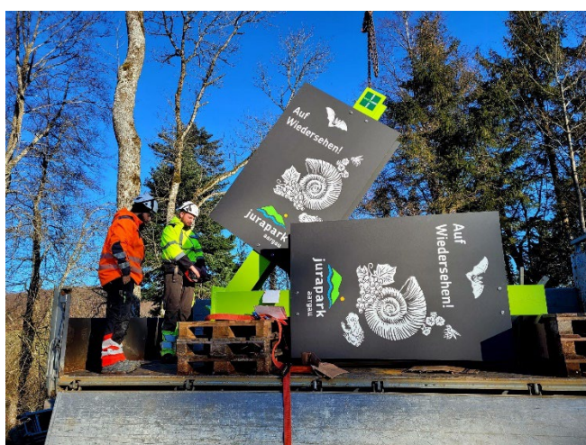
Sechs Eingangstafeln wurden bis jetzt montiert © Jurapark Aargau
